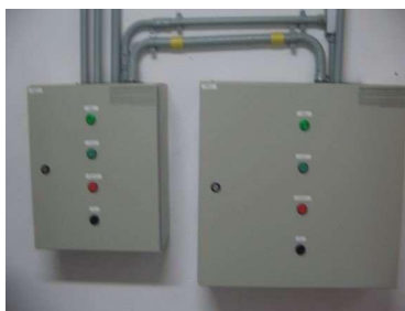
Detalhe quadro comando
