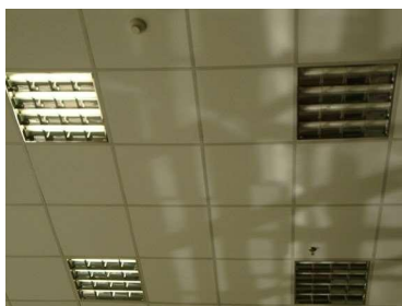
Detalhe iluminação forro
