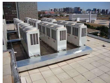
Condensadoras ar condicionado
