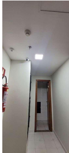
Detalhe iluminação serviço
