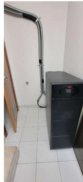
Detalhe no-break 14 andar
