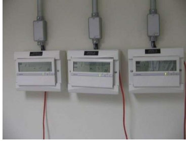
Detalhe controladora ar condicionado
