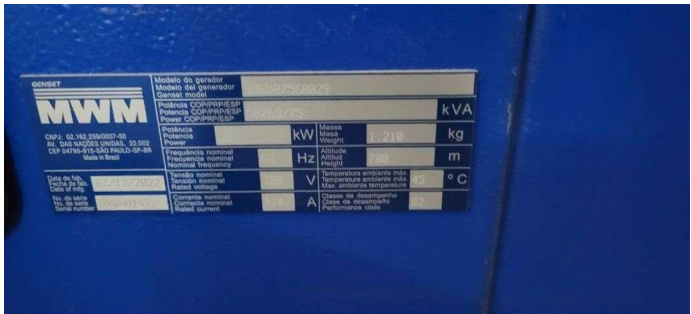
Detalhe placa de identificação gerador 2
