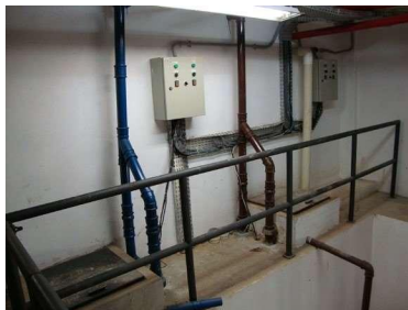
Detalhe quadro comando
