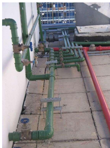
Barrilete distribuição água
