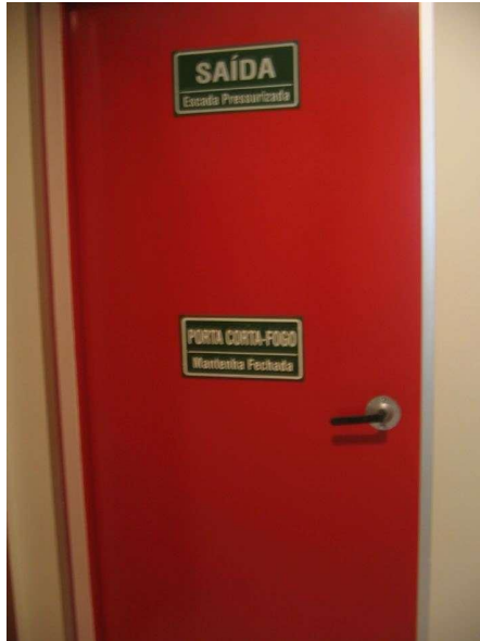
Detalhe porta corta fogo serviço.
