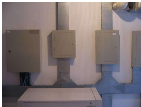
Detalhe quadros de distribuição
