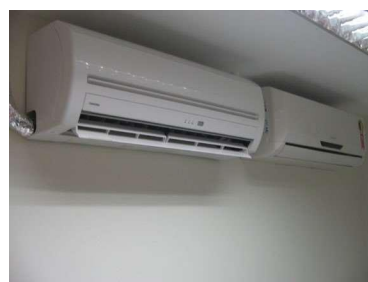
Detalhe ar condicionado Split e Cassete 02 vias
