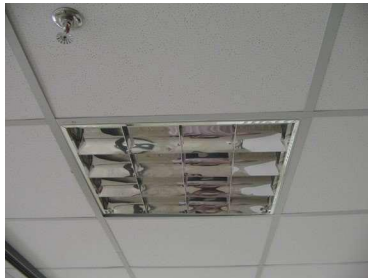
Detalhe iluminação forro
