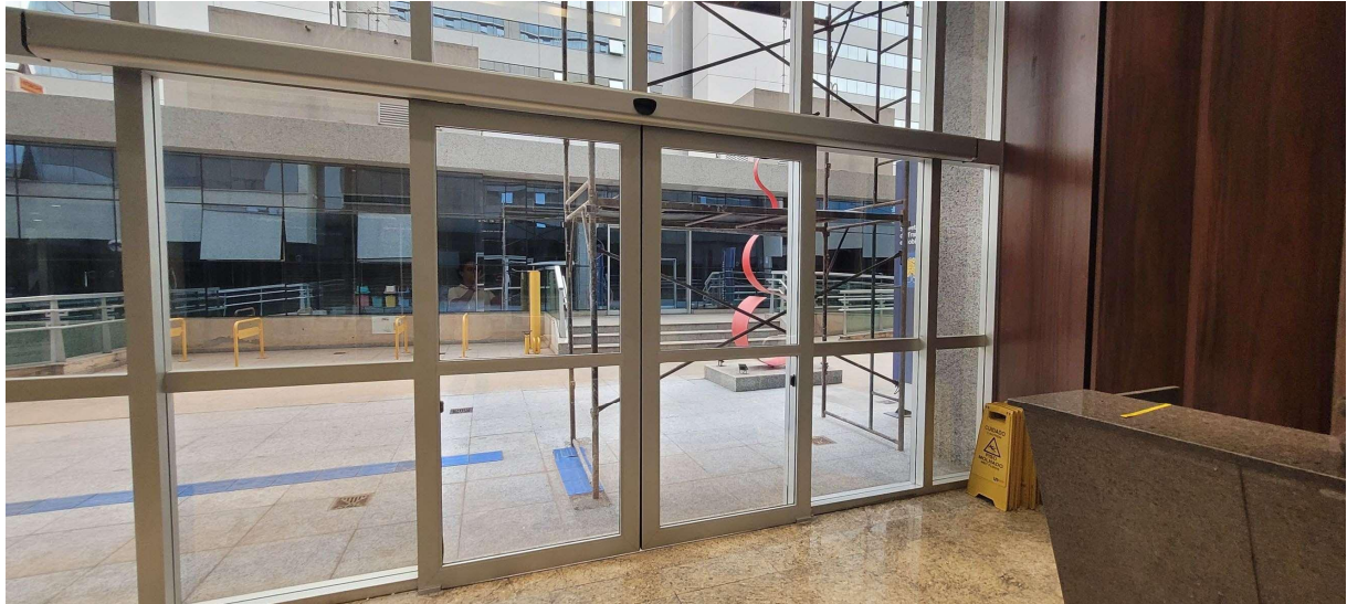
Detalhe automação porta
