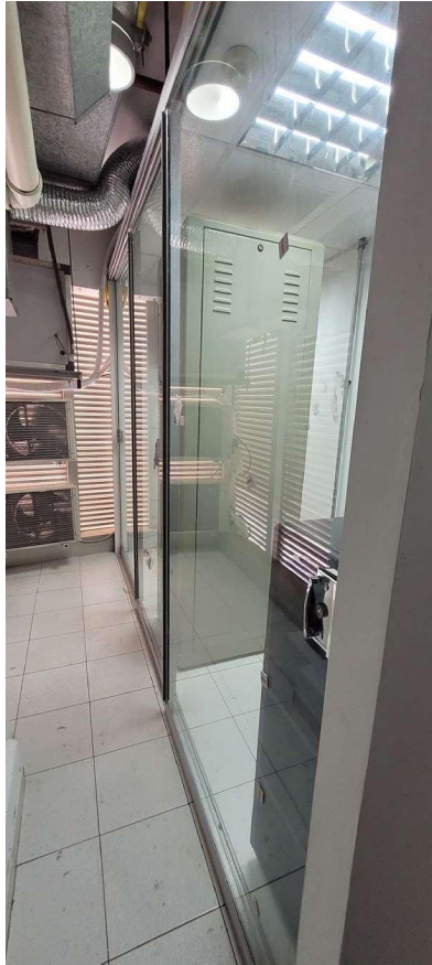
Detalhe Sala Técnica
