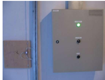
quadro exaustão e renovação ar
