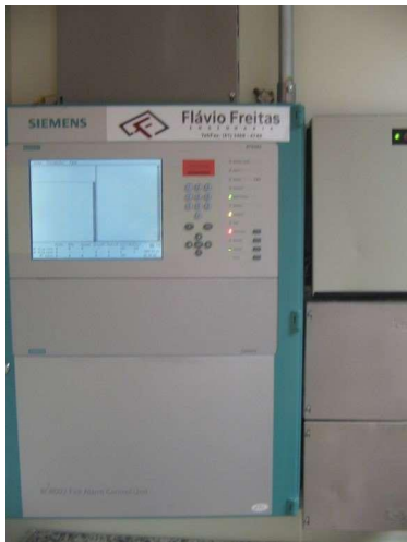
Detalhe central de alarme
