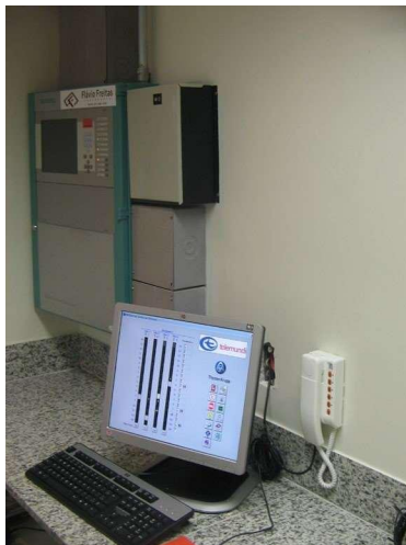
Tela automação elevador
