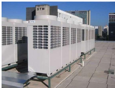
Condensadoras ar condicionado
