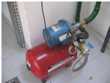
Bomba pressurização água
